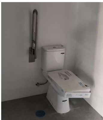
Aseo accesible adaptado para PMR
