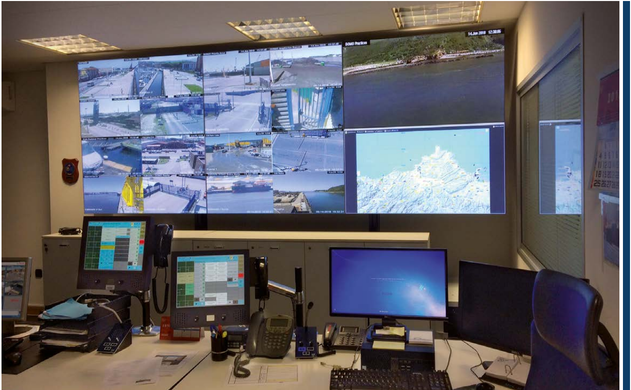
Nuevo centro de Control del Puerto de Avilés con el SPA. Diciembre de 2018 / New control centre with SPA at the Port of Avilés. December 2018.
